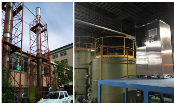
Рис. 6. Установка обработки отработанных газов нано-микробузырьками NSIW
